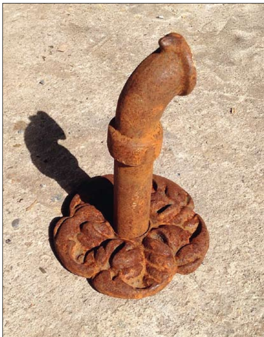
Obr. 36: Litinový chrlič degradovaný rzi. (Foto E. Olšanová, 2014)
