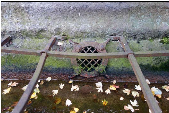
Obr. 37: Povrch železných dílů dlouhodobě neprovozané kašny degradovaný atmosférickou korozí. (Foto J. Olšan, 2016)
