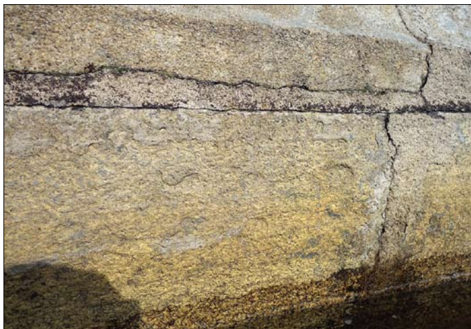
Obr. 32: Stěna bazénu fontány obložená kamennými deskami, povrchová část spár mezi deskami vyplněná materiálem na bázi umělého kamene je rozpraskaná olivem teplotních dilatací konstrukce zdiva. (Foto J. Olšan, 2016)
