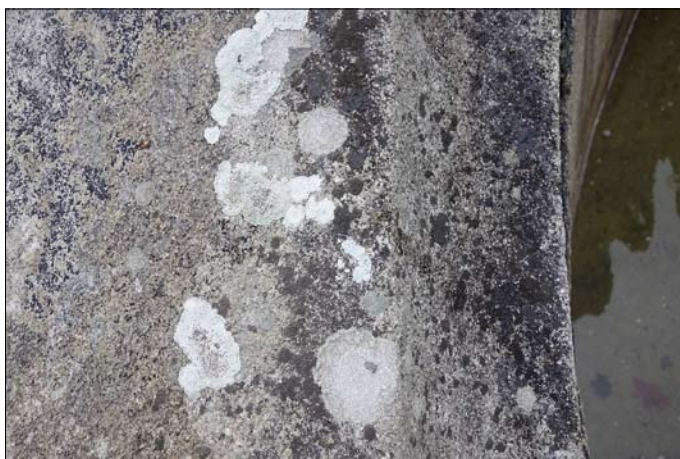
Obr. 29: Lišejníky na povrchu kamenného obkladu stěn bazénu fontány. (Foto J. Olšan, 2016)
