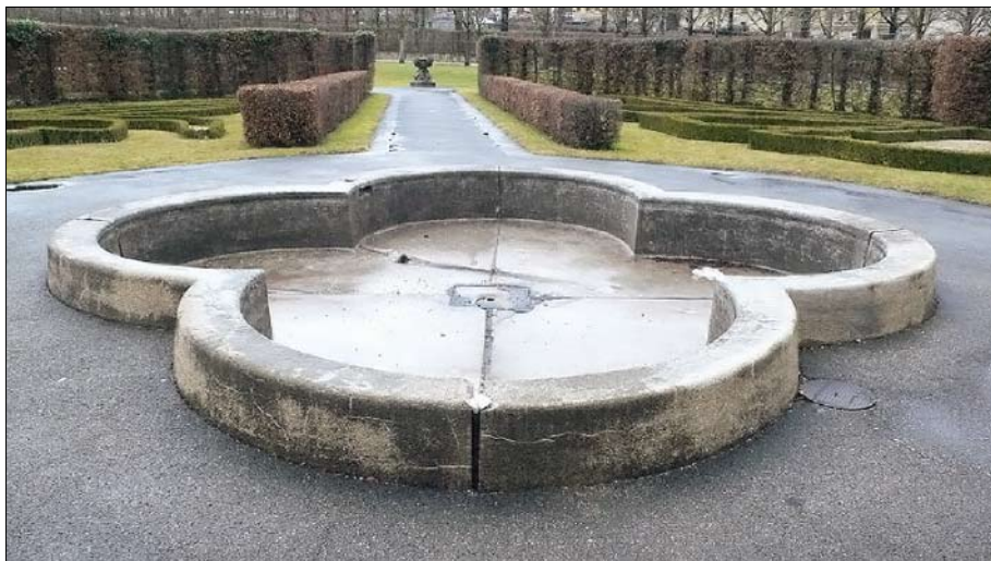
Obr. 35: Ludwigsburg, Německo – fontána v zámecké zahradě, degradovaná železobetonová konstrukce z roku 1954, stav před rekonstrukcí. ( www.nuethen.de )
