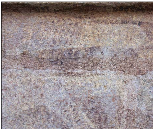
Obr. 41: Povrch kamenného obkladu stěny vodního prvku po nevhodně provedeném mytí tlakovou vodou. Nerovnoměrná barevnost povrchu svědčí o tom, že při mytí se nacházela tryska vysokotlakého čističe příliš blízko omývané stěně. Výsledkem neodborného postupu obsluhy čističe je jednak nestejnoměrně umytý povrch konstrukce vodního prvku, ale pravděpodobně také degradace jejího povrchu příliš vysokým tlakem dopadající vody. (Foto J. Olšan, 2016)
