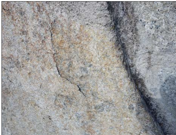
Obr. 40: Detail degradovaného povrchu obkladové desky stěny fontány z krystalického vápence. Konstrukce vodních prvků z přírodního kamene, jejichž povrch je degradován, není možné omývat tlakovou vodou. (foto J. Olšan, 2016)
