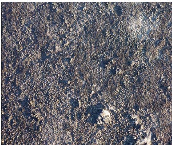
Obr. 26: Povrch desky z mušlového vápence degradovaný působením kyselých dešťů, vymýváním vápencového pojiva došlo k vydrolení menších zrn, větší a odolnější úlomky křemene a žilců v kameni zůstávají, úbytek povrchu činí v průměru až 0,5 cm. (Foto J. Olšan, 2016)
