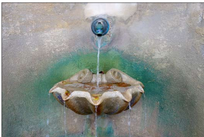
Obr. 38: Poškození omítky kašny depozity měděnky. (Foto J. Olšan, 2016)
