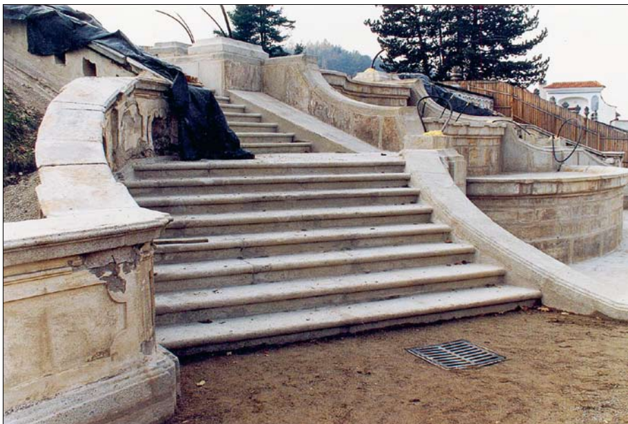
Obr. 112: Rekonstrukce stavební části fontány, stav na jaře roku 1998 po dokončení stavebních prací a před osazením proků sochařské výzdoby fontán. (Foto L. Pouzar, 1998)
